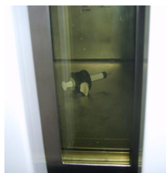
Dettaglio del visore della precamera di intercomunicazione fra la zona A e la zona B
