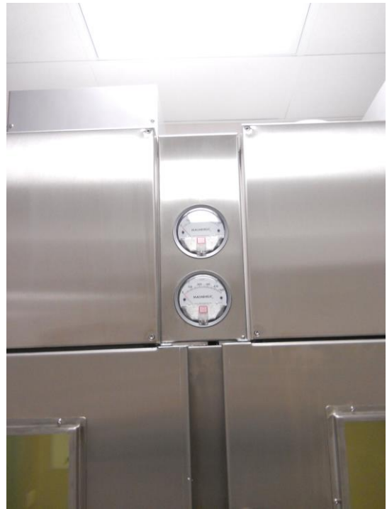
Esempio di realizzazione - Dettaglio dei manometri differenziali utilizzati per valutare la differenza di pressione fra la cella e il locale in cui è installata la cella
